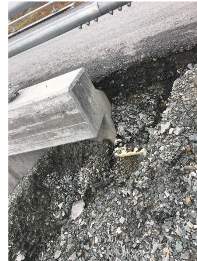
Vanlig erosionsskada -ände kantbalk
