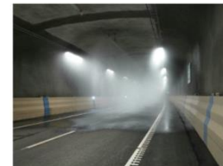
Bild 2 Det nya brandbekämpningsystemet har funnits i Norra länken i Stockholm sedan 2014. Foto: Trafikverket.
